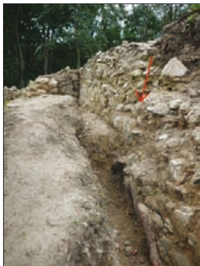
10. Zewnętrzne lico muru zachodniego (widok od południa, strzałką oznaczono miejsce wypchnięcia muru)
